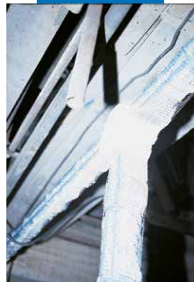
Разрушена бетонна конструкция
